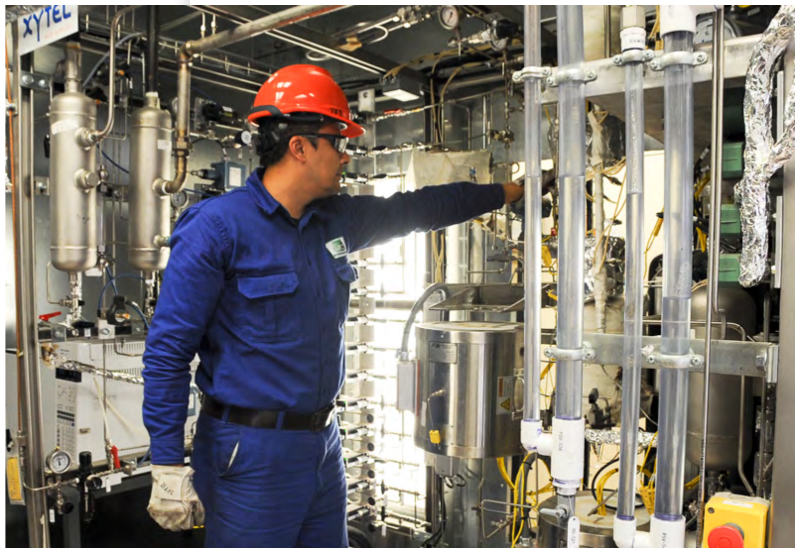
Planta piloto de lecho fluidizado.
