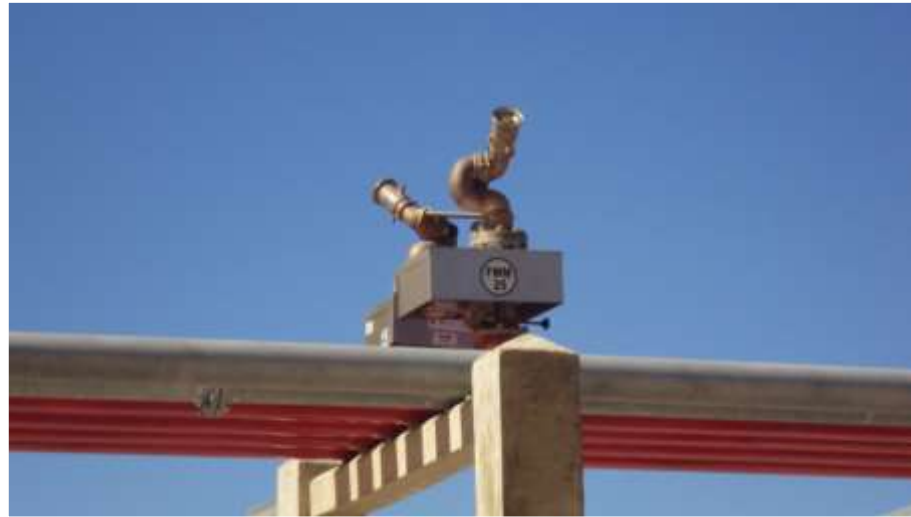
Equipos de Agua Contra incendio Fijos
