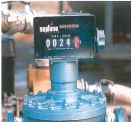
Figura 17. Medidor de flujo
