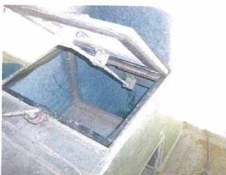
Figura 11. Válvula de escape de la chimenea.
