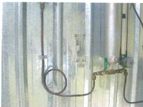
Figura 18. Tubería de cobre.
