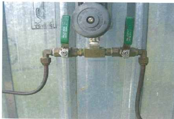
Figura 13. Llaves de paso de una cámara de fumigación.
