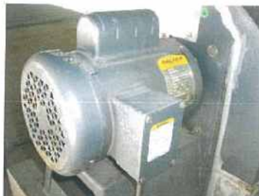
Figura 16. Motor de cámara de fumigación
