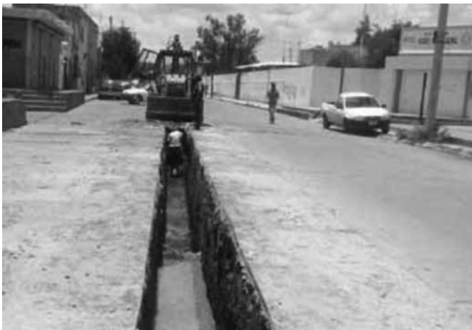
Figura 1.7 Descoordinación intragubernamental: se realizan obras hidráulicas después de la pavimentación de calles
