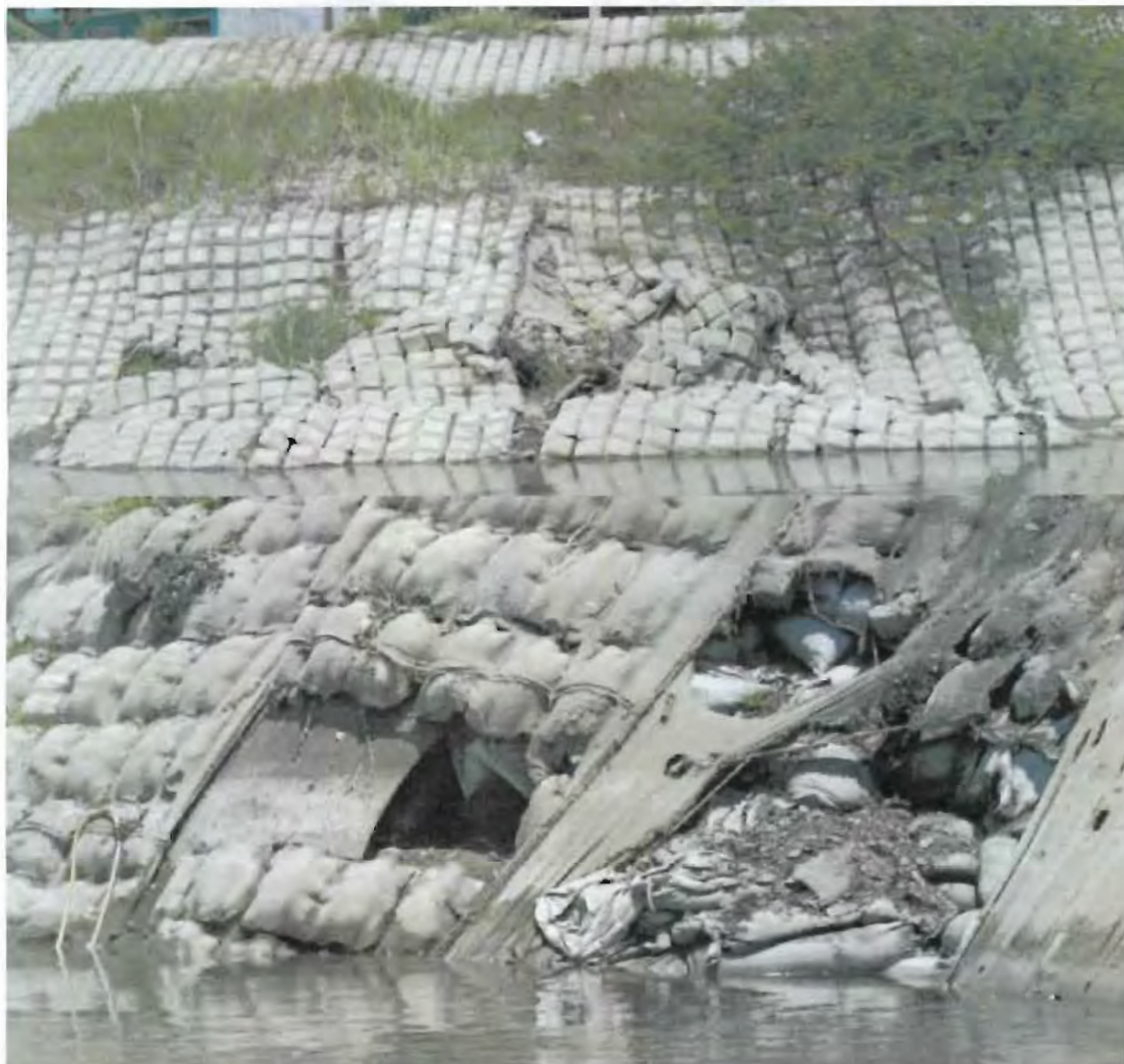
Figura 5.e. 16 y 17. De manera similar al caso de la fotografía anterior, donde se encontró abierta la protección contra la erosión fluvial, se halló que tras éstas el suelo superficial ha sido erosionado, siendo el desfogue del flujo subterráneo la causa más probable.
