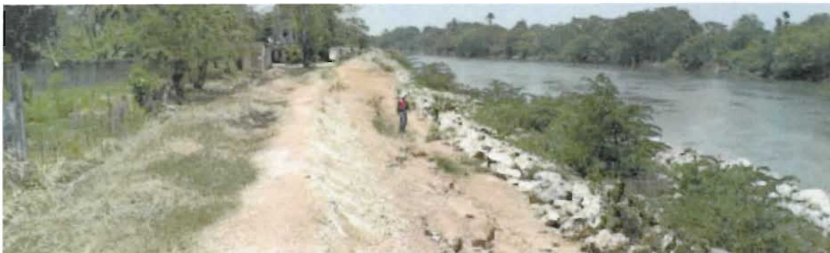
Figura 5.e. 12. En "La Pigua" también se presentó un hundimiento del terreno bajo un terraplén reforzado ("tierra armada"), apareciendo en superficie una oquedad importante. Nótese la inclinación hacia el cauce de la margen hundida, lo que no corresponde a una falla circular.
