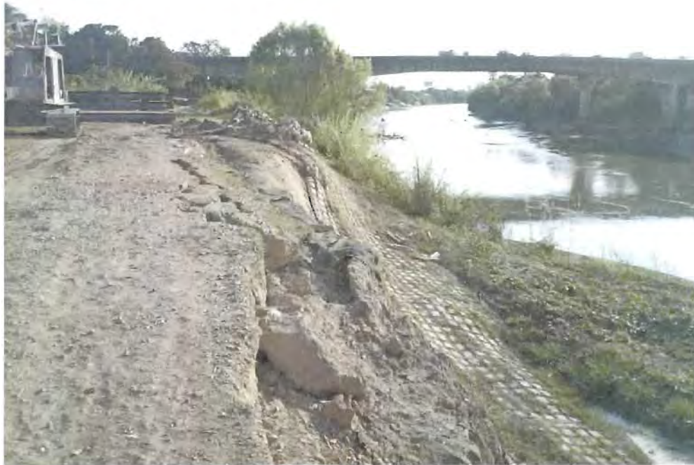
Figura 5.e. 3. Colapso de la margen y agrietamiento por volcamiento incipiente.
