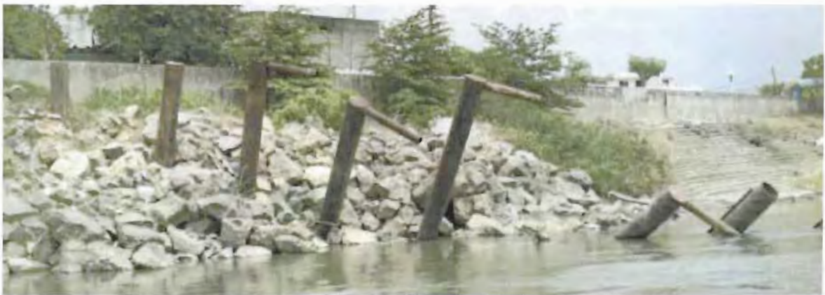
Figura 5.e. 2. En la mayoría de las márgenes "protegidas" con pedraplenes el subsuelo fue incapaz de soportar su peso. La inclinación de los pilotes y el hundimiento manifiestan que, lejos de tratarse de una típica falla de talud de sección circular a volumen constante, se produjo el colapso y volcamiento de la margen, incluyendo a los pilotes.
