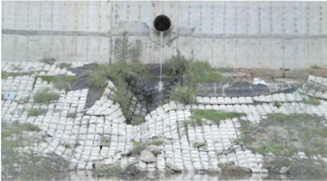
Figura 5.e. 21. Algún efecto dispersivo parecen tener las aguas negras, pues en distintos sitios donde las descargas escurren sobre la margen, ésta resulta notablemente más erosionada que sus flancos, como en este sitio protegido de la margen derecha de un brazo de Río Usumacinta, en Balancán, donde el agua negra se infiltra entre las tabletas de concreto de la protección.
