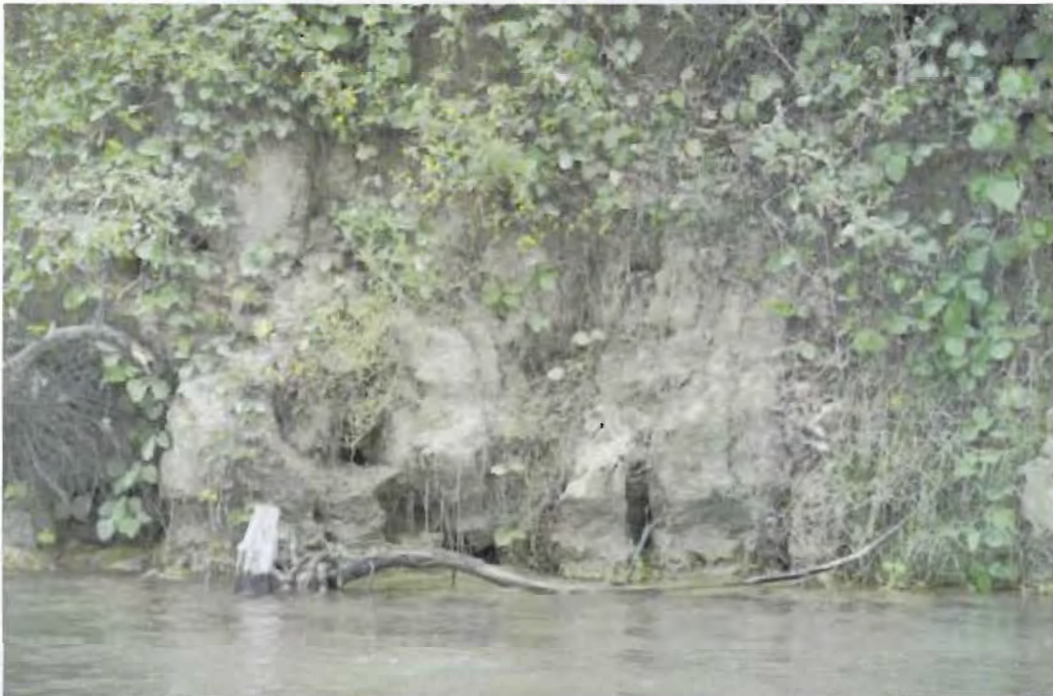
Figura 5.e. 10. Las grietas son vías preferentes del flujo subterráneo que éste amplía y profundiza rápidamente, debilitando las márgenes y propiciando el derrumbe de bloques desprendidos.
