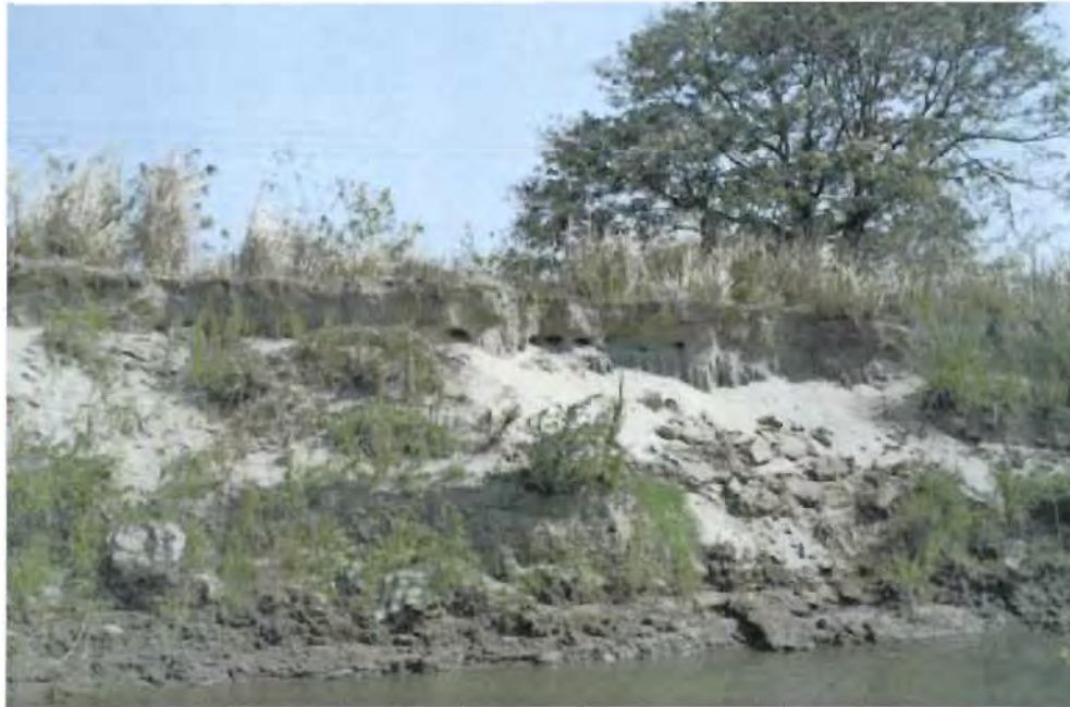
Figura 5.e. 7. Erosión interna de una capa de arena.
