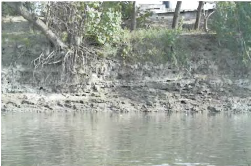
Figura 5.e. 8. Erosión marginal por derrumbe de un suelo minado por erosión interna.
