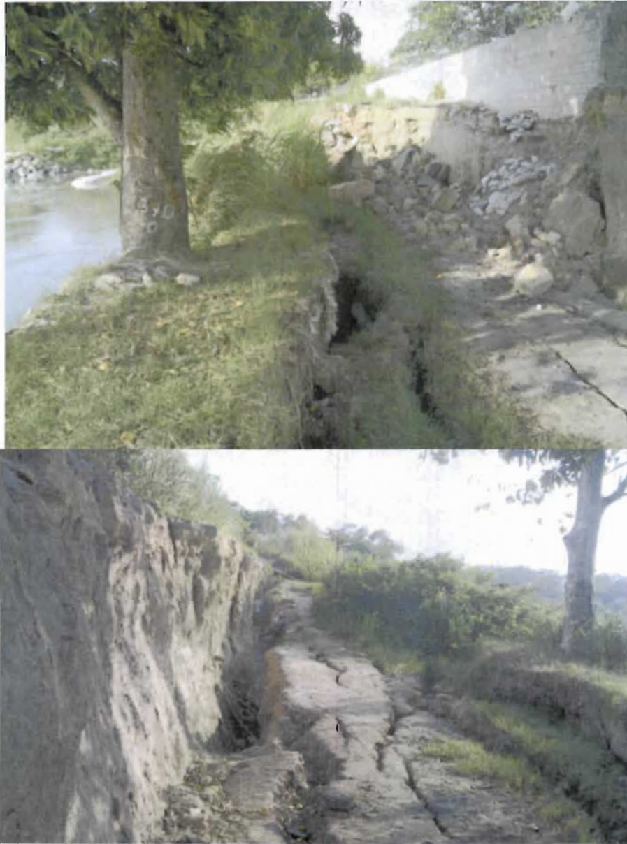
Figura 5.e.s 19 y 20. En la margen izquierda del Río Carrizal, en el tramo d la Zona Industrial de Villahermosa, se presentó la evidencia más clara de erosión interna cuando, sin corrimiento de la margen se hundió la superficie junto a ella, dejando ver importantes oquedades bajo el bloque caído.
