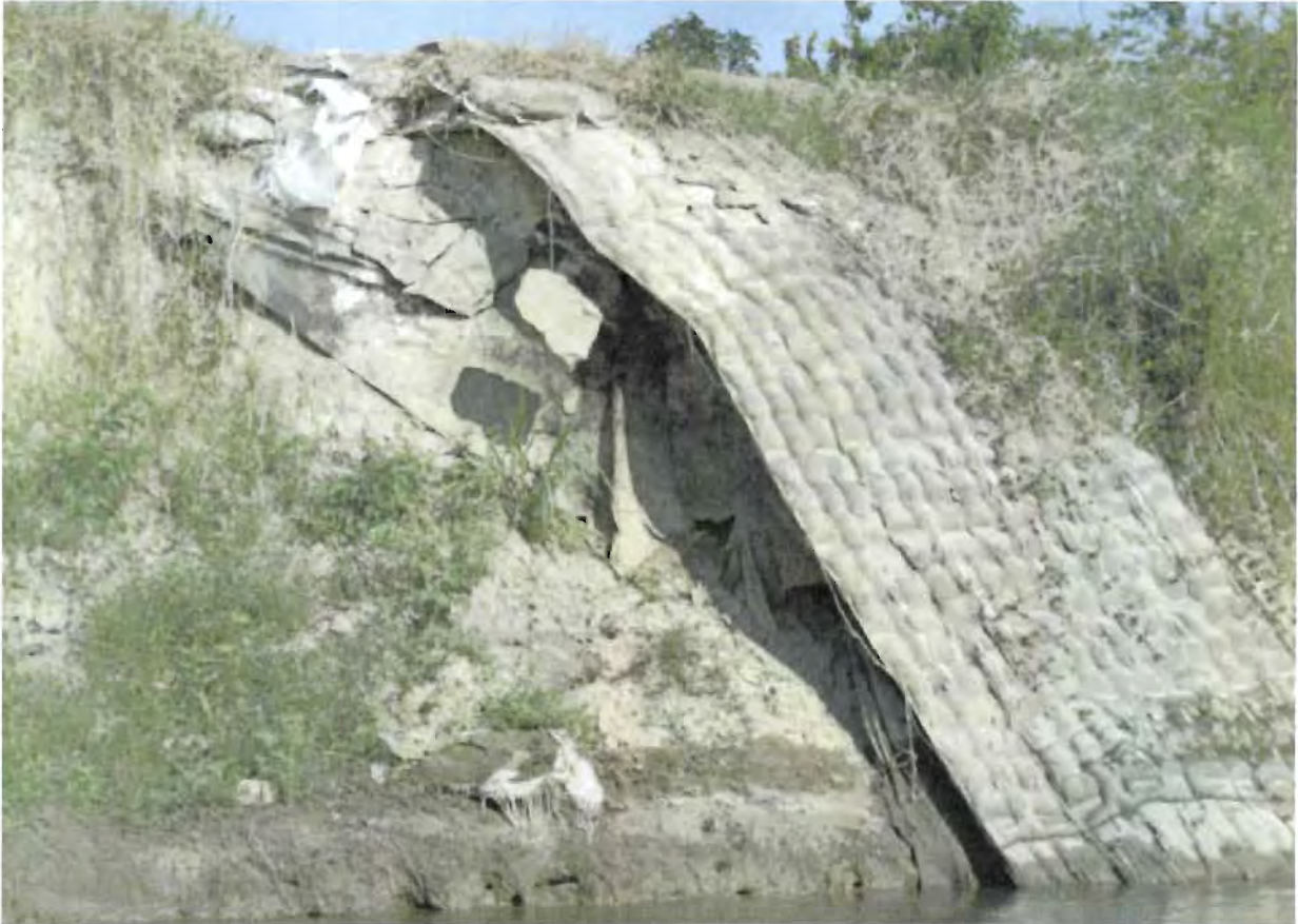
Figura 5.e. 15. Donde fue posible observar los extremos de las protecciones contra la erosión fluvial, se halló que tras éstas el suelo superficial ha sido erosionado, siendo posible que la causa sea el arrastre de partículas cuando el flujo subterráneo alcanza la superficie. En este caso es el extremo de aguas arriba de la protección.
