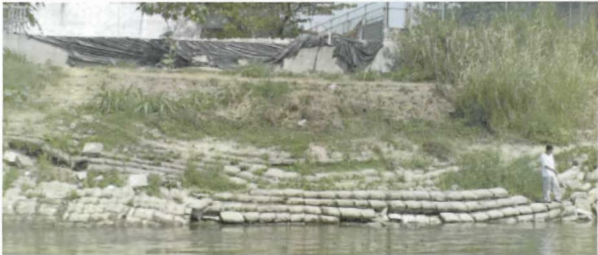
Figura 5.e. 14. Hundimiento bajo una "protección" de costales de mortero.
