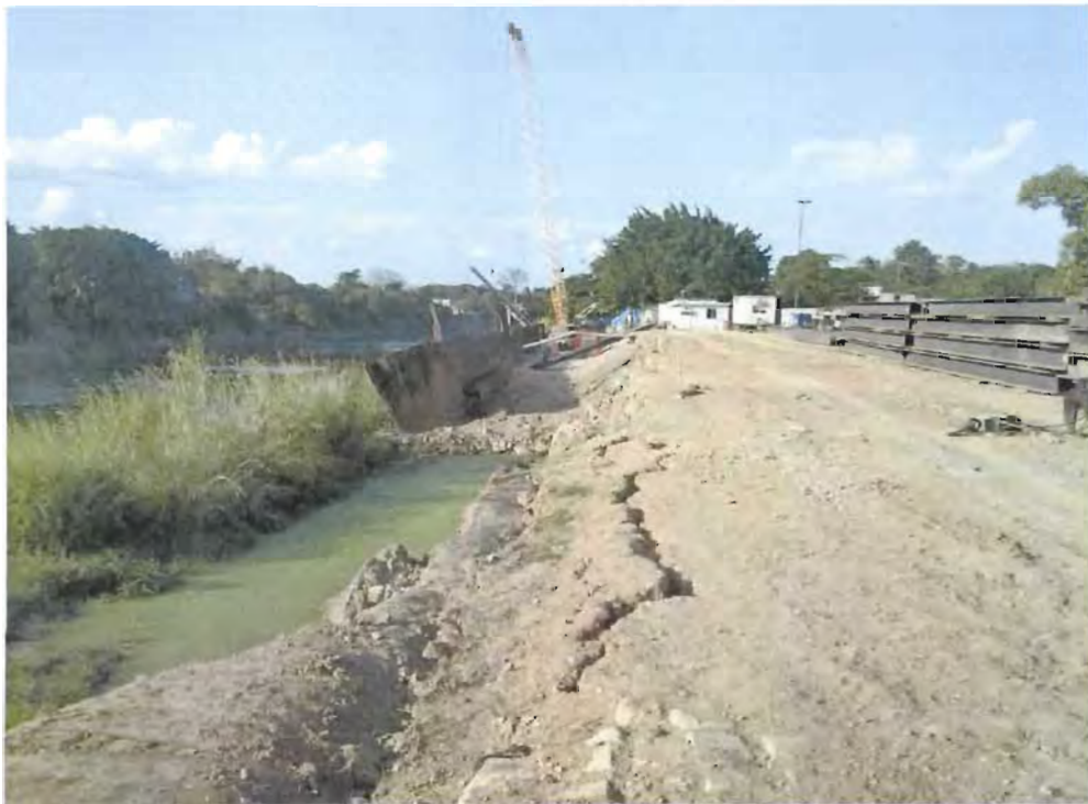
Figura 5.e. 4. En el mismo sitio de la figura anterior se observa la superficie hundida (cubierta por vegetación) de la margen colapsada y agrietamiento por volcamiento incipiente que incluye a las tablaestacas que inútilmente tratan de contenerlo.
