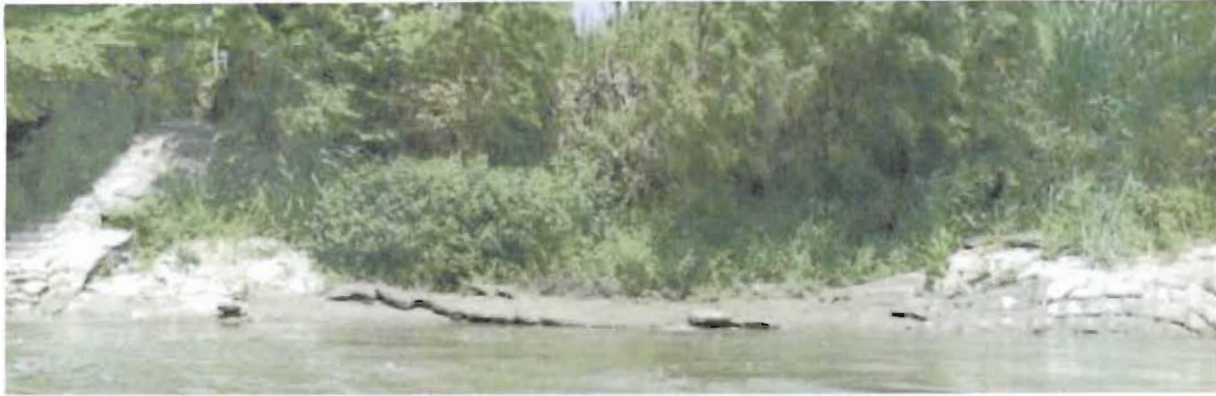
Figura 5.e. 13. Hundimiento bajo una "protección" de colchacrete.
