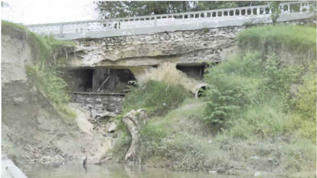
Figura 5.e. 23. En la margen derecha del Río Usumacinta, en Tenosique, alrededor de una descarga de drenaje municipal al lado del embarcadero, la erosión interna bajo el malecón ha adquirido dimensiones de consideración. De no atenderse con presteza este problema, la reparación y las consecuencias podrán ser extraordinariamente costosas, ya que la erosión avanza bajo la ciudad y puede existir bajo otros sitios.
