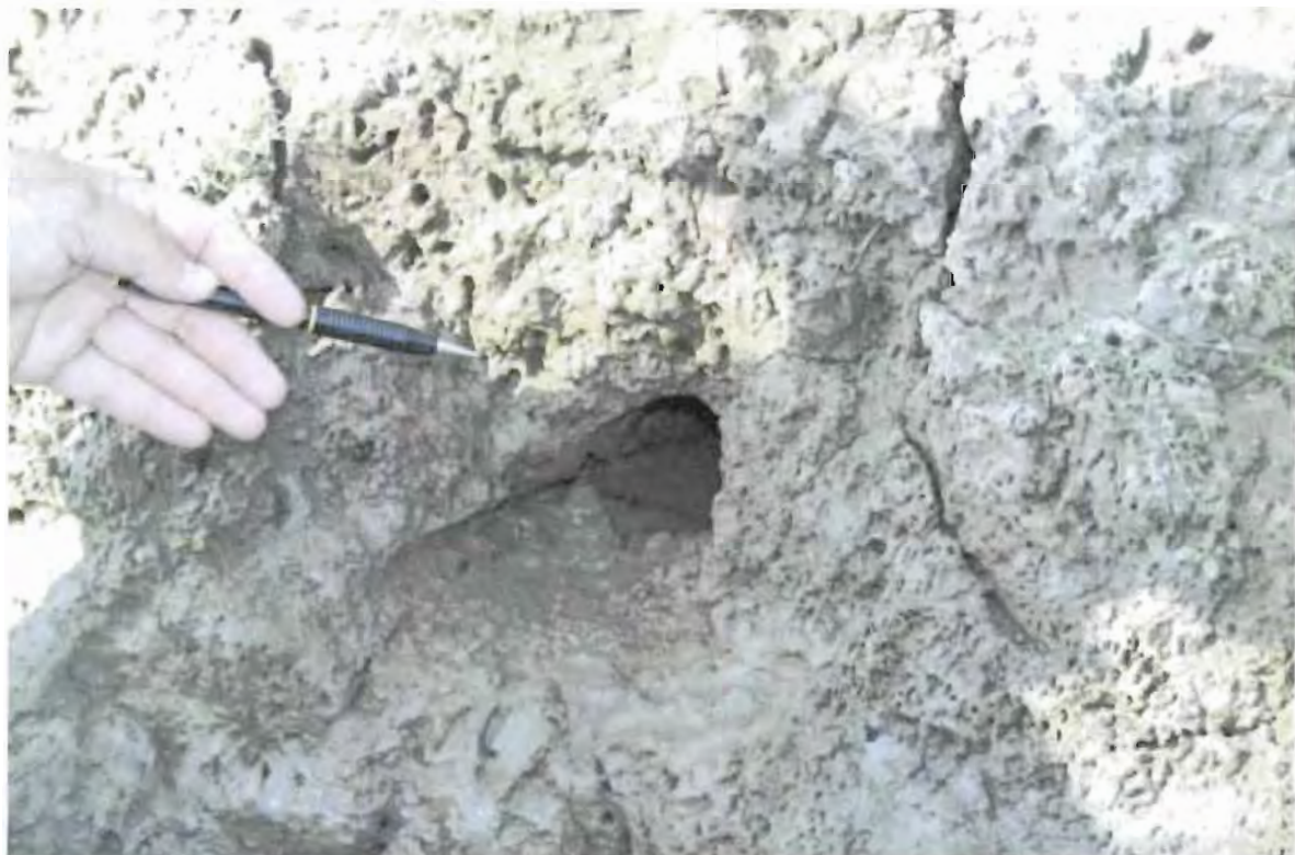
Figura 5.e. 6. Horadaciones realizadas por diversos animales en una superficie agrietada y fisurada de suelo poco cohesivo; las fisuras y grietas son vías preferentes del flujo subterráneo y por tanto de erosión interna.
