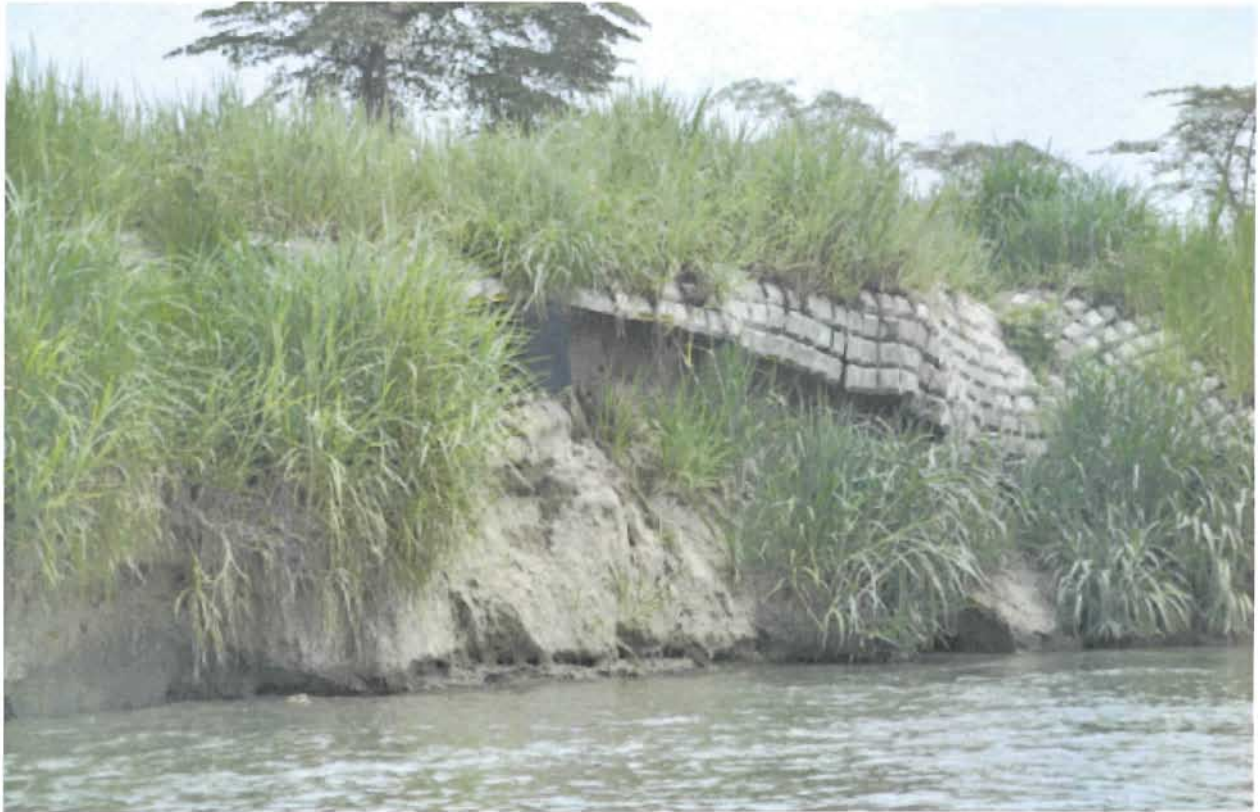
Figura 5.e. 11. En este sitio, la erosión interna de la capa observada al nivel del agua dejó sin soporte a las capas superiores que se derrumbaron por desprendimiento, dejando colgada la protección contra erosión fluvial que resultó inútil para evitar este tipo de erosión marginal.
