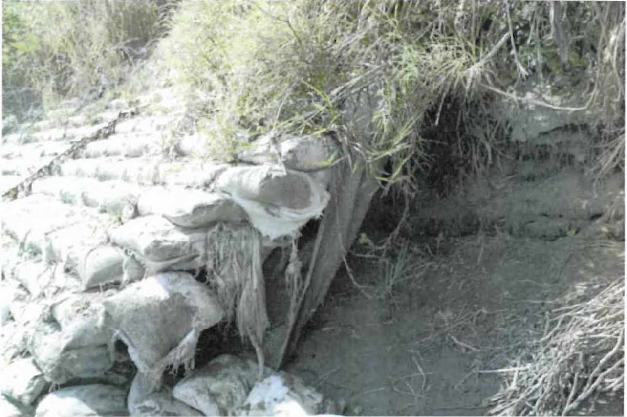
Figura 5.e. 18. Mismo pie de fotografía que la fotografía 12, sólo que en este caso se trata del extremo de aguas abajo de la protección.
