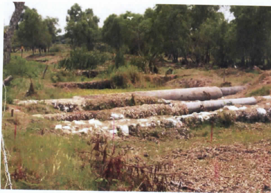
Figura 11.93.- Ductos de Pemex que son obstáculo para el libre tránsito de las corrientes superficiales. FUENTE: CENAPRED, 2008.
