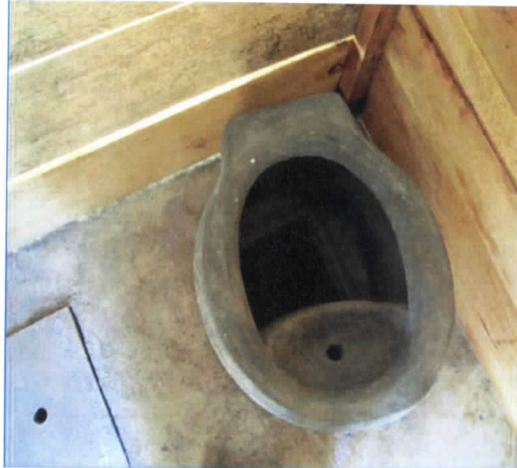
Figura 11.69.- El sistema de los sanitarios secos funciona por deshidratación y evaporación. FUENTE: UNIVERSA, 2011 26 .
