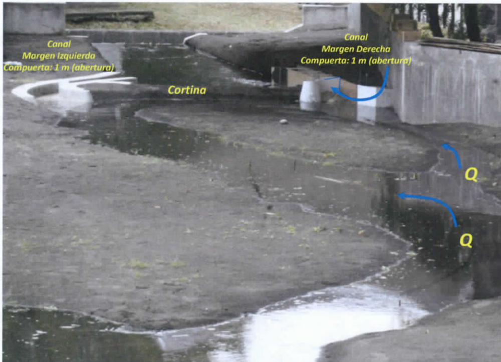
Figura 9.56 Vertedores compuertas con abertura de 1 m
