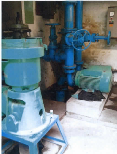
Figura 9.37 Casa de máquinas
