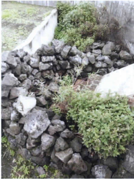
Figura 9.36 Presencia de vegetación en el tanque de disipación
